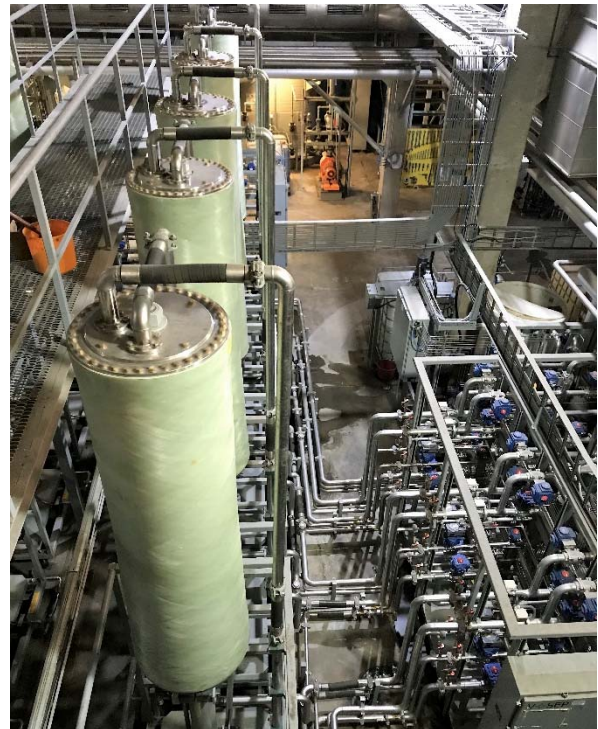
VSEP-System als Herzstück der Aufbereitungsanlage
